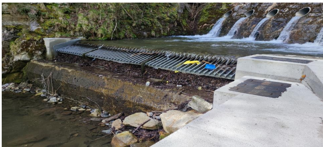
Fotografia 12. Central hidroelèctrica del riu d'Ós. A dalt, sortida d'aigües de la central. A sota, zona de captació.
